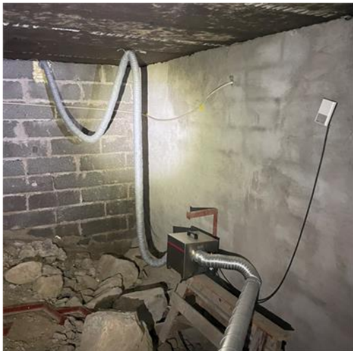
Grund med avfuktare
